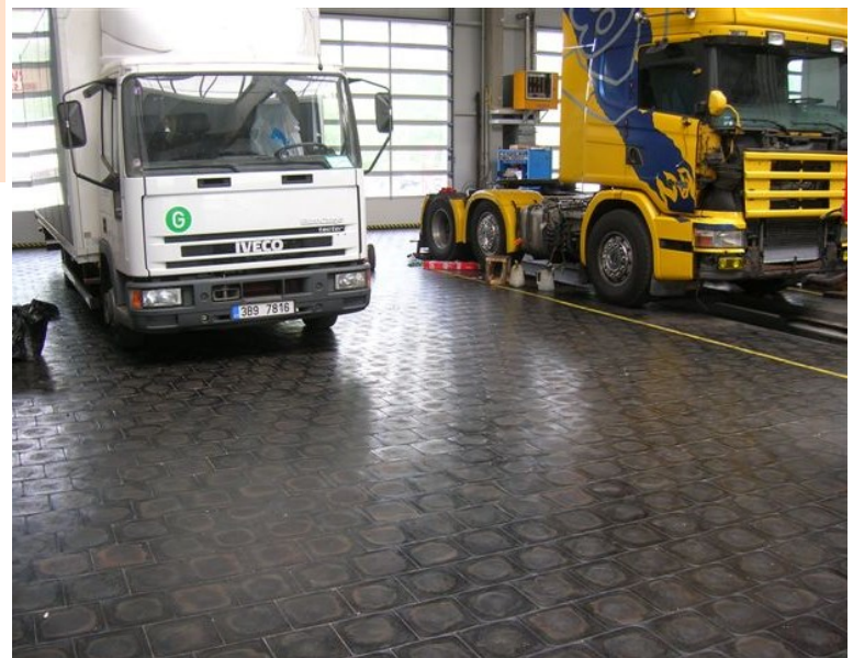
Widerstandsfähiger Fußboden in einem Truck-Zentrum (250/250/22JR)
